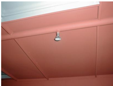
Löschwasserleitung mit Sprinkler
